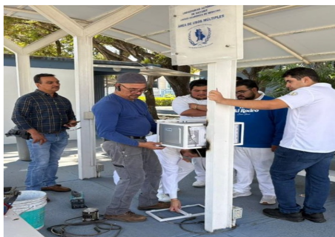
Foto 66. Instalación del microondas para utilización por estudiantes del comité en área común.
