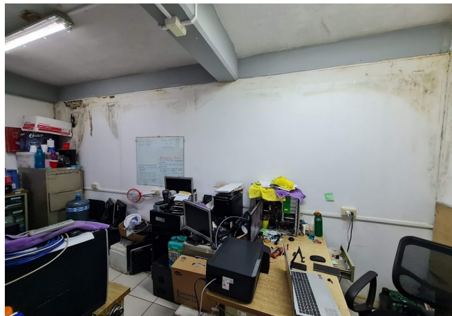
Foto 82. Área de Tecnología Educativa con humedad en pared de Tablaroca, junio 2025.
