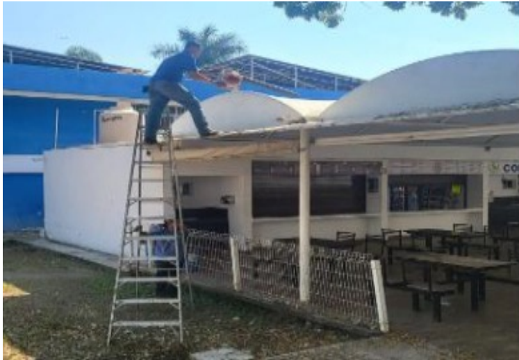
Foto 95. Limpieza de toldo del área de cafetería, febrero 2026.
